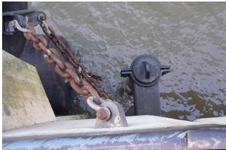
Abb. 12: Ungesicherter Pfahlkopf (Draufsicht)
